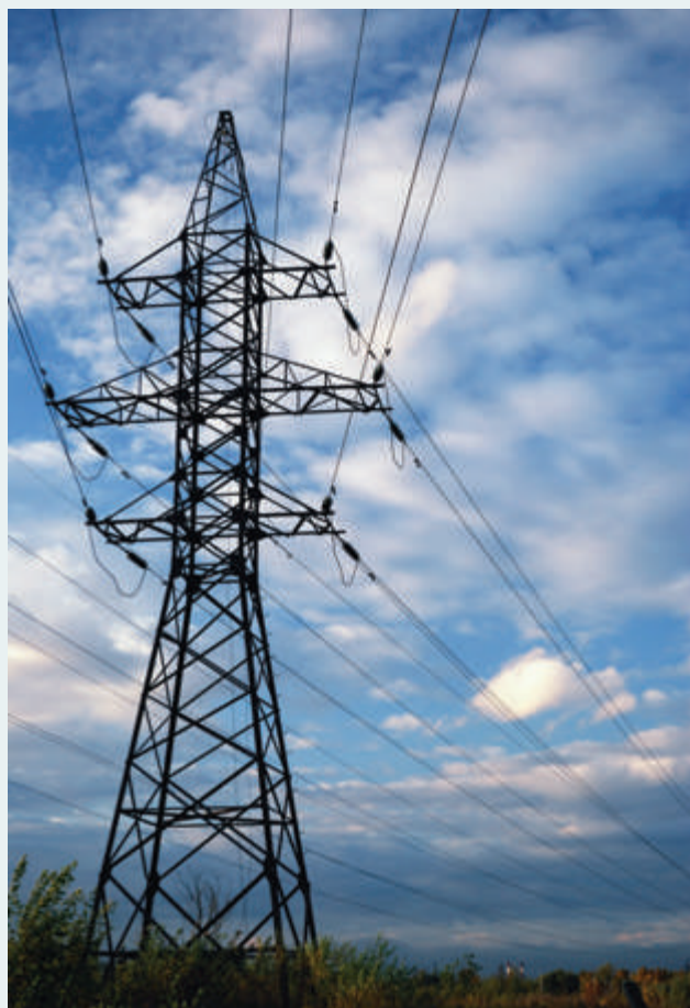
Алюминевые провода высоковольтных линий электропередач
