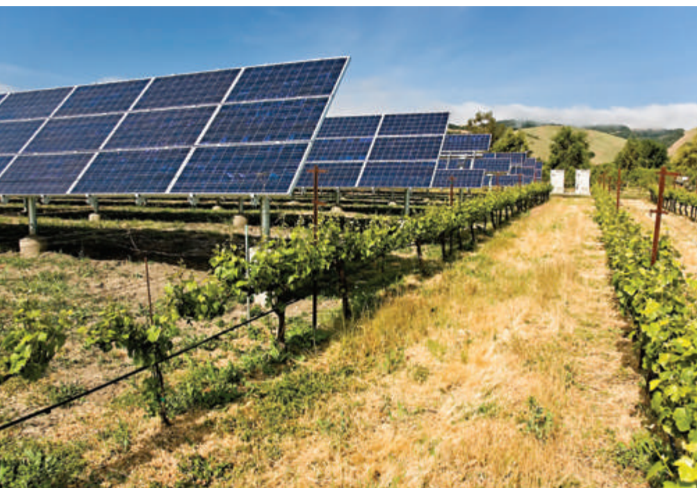
Калифорния, виноградник, солнечная электростанция
