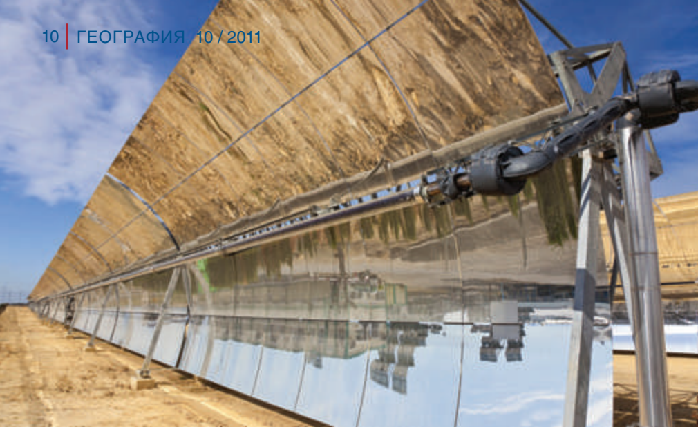
Параболический зеркальный жёлоб-концентратор солнечно-тепловой электростанции. В фокальной зоне — трубка с жидким теплоносителем
